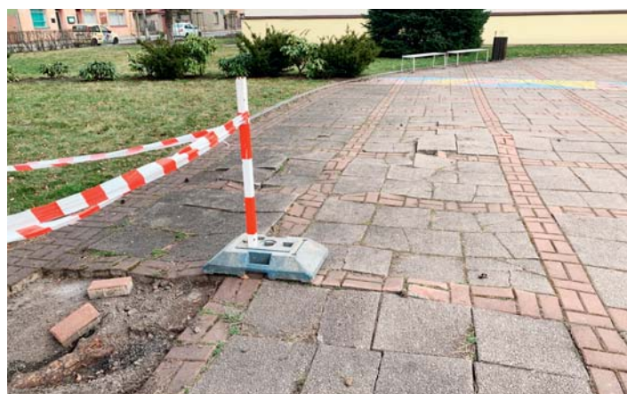
Dlažba poničená kořenovým systémem borovice. Oprava chodníku si vyžaduje odstranění stromu.
