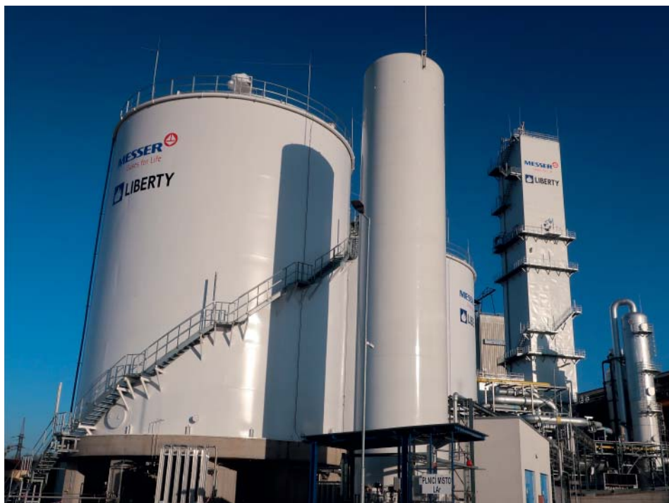
Nová jednotka na separaci vzduchu (ASU) ve Vratimově.
